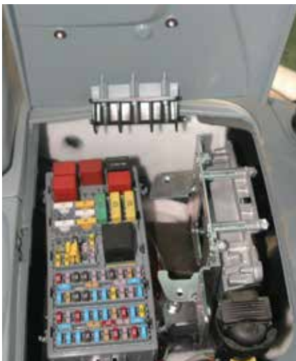
Die Sicherungen sind unter einer Abdeckung vor dem Ganghebel zu finden.
